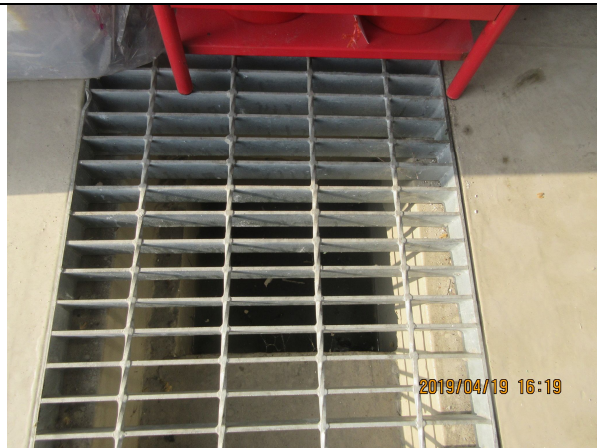
危废仓库-集液池
