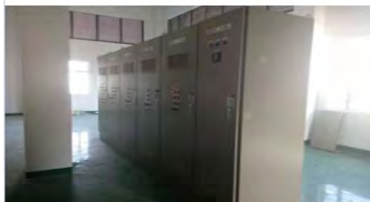
电柜安装完成
