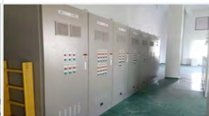
电柜安装完成
