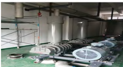
曝气风机安装完成
