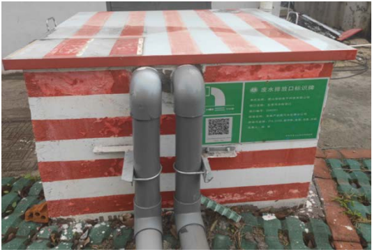
生活污水排放口
