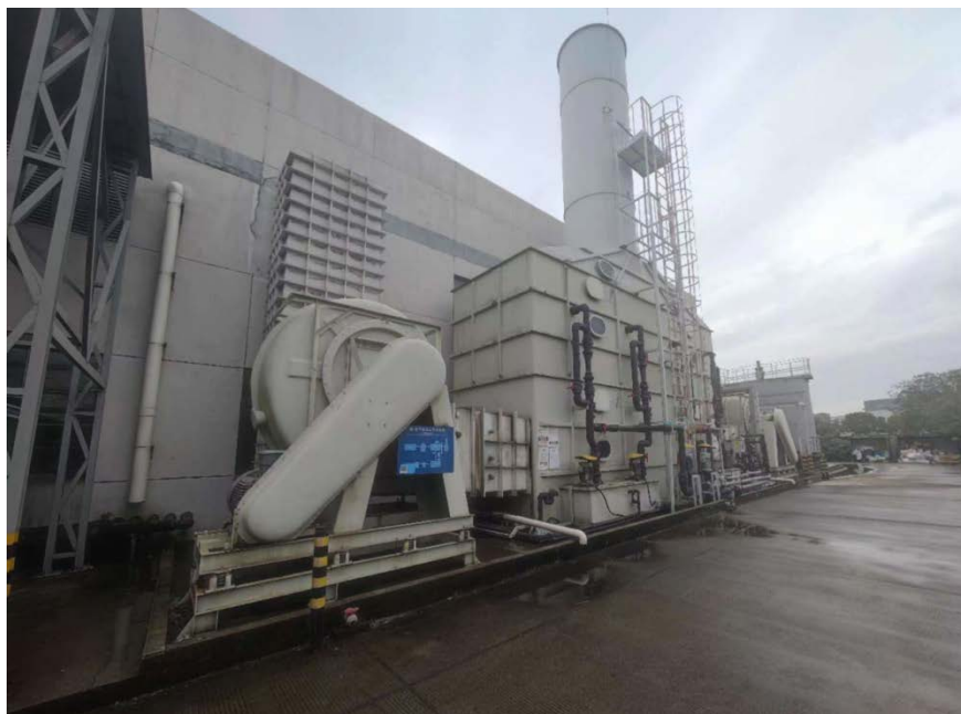
图 3.1.7-1 现有废气治理设施及排气筒
