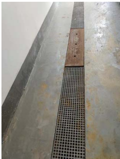
危废仓库设置收集池及导流沟槽
